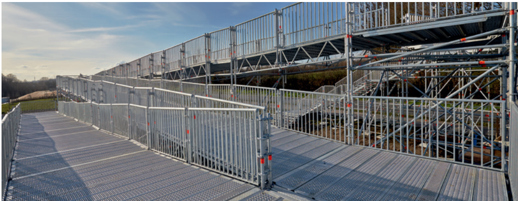
Pasarela sobre carretera muy transitada con rampa de 2,5 m. de ancho y pendiente apta para sillas de ruedas.
